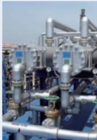
水素膜分離装置
