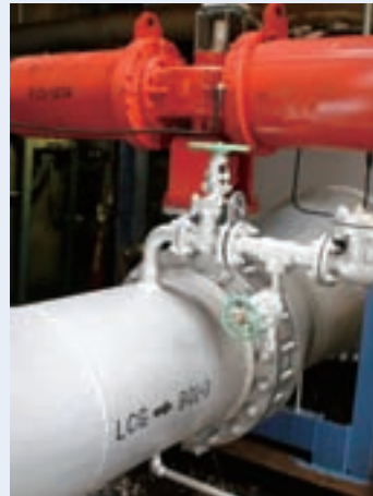
製油所ボイラーへ燃料を供給する配管 ▲
