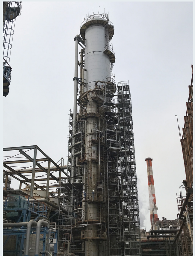
常圧蒸留装置メインタワー
