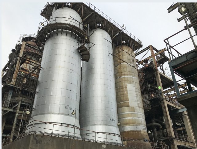
減圧軽油水素化脱硫リアクター(補修後)
