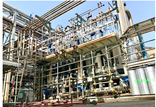
2023年定期修理工事において改造工事を行った水素膜分離装置
